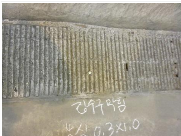
Span24 집수구 토사퇴적 및 스틸그레이팅 부식
