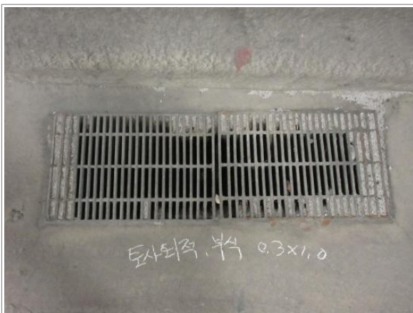
Span118 집수구 토사퇴적 및 스틸그레이팅 부식
