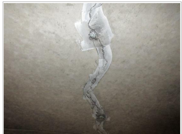
Span156 천단부 종균열(cw=0.3mm/9.0m, 보수미흡)
