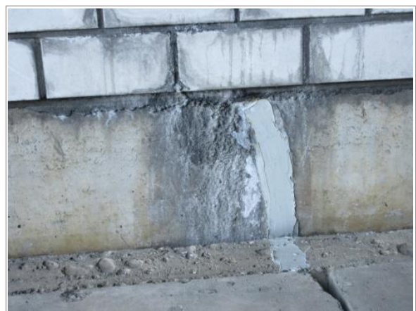
Span181 벽체부 백태(0.3×0.5)
