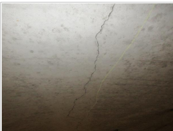
Span62 천단부 종균열(cw=1.5mm/9.0m)
