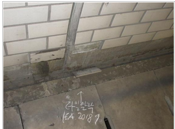
Span142 측벽부 타일 탈락
