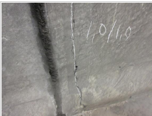
Span40 공동구 벽체 균열(1.0mm/1.0m)
