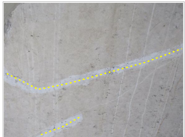
Span169 천단부 사균열(cw=0.2mm/2.5m)
