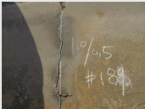
Span1 측구 균열(1.0mm/0.5m)
