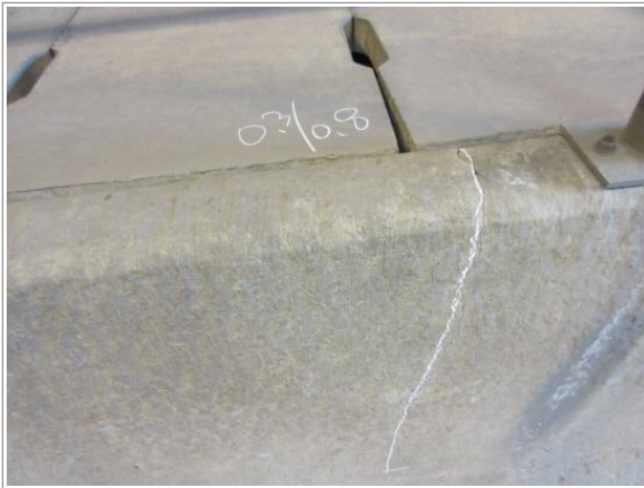
Span6 공동구 벽체 균열(0.3mm/0.8m)
