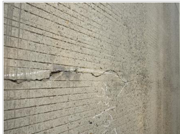
Span3 포장면 균열
