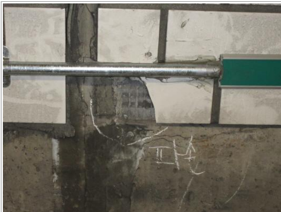
Span93 측벽부 타일 파손
