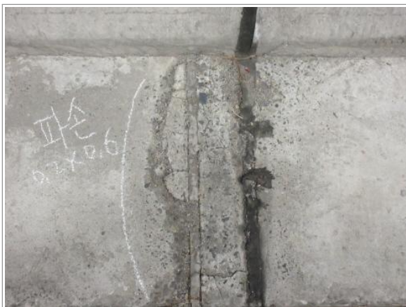
Span126 측구 파손(0.2×0.6)
