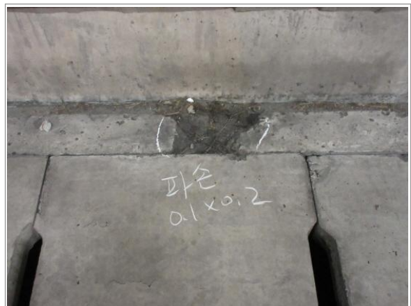
Span56 공동구 벽체 파손(0.1×0.2)
