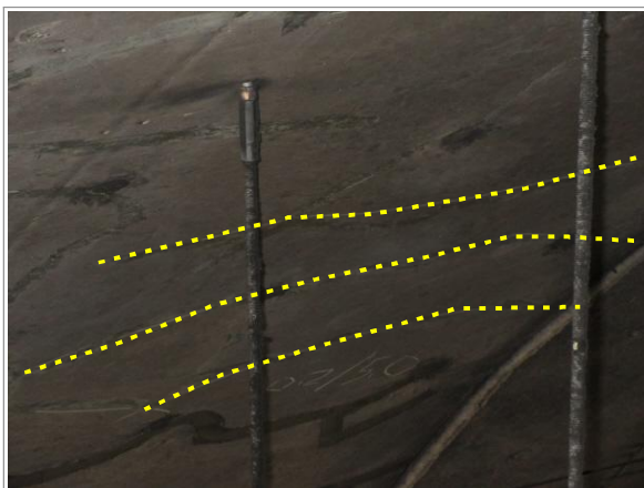
Span179 천단부 종균열(cw=0.2mm)
