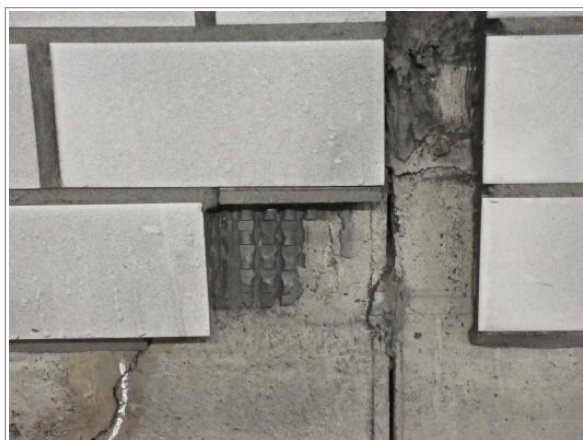
Span104 측벽부 타일 탈락
