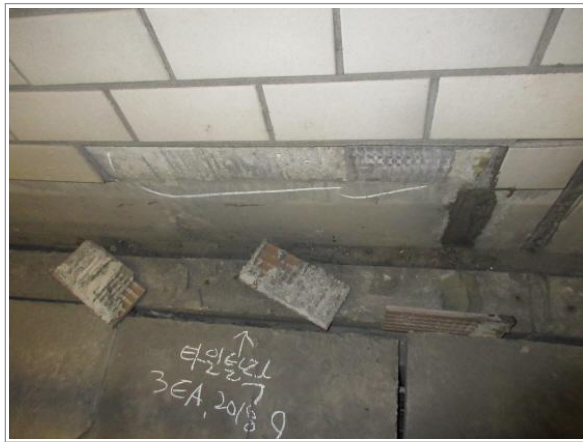
Span144 측벽부 타일 탈락
