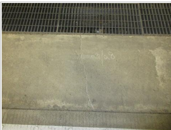
Span93 측구 균열 (0.3mm/0.8m)
