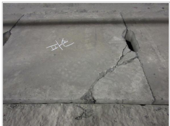
Span148~151 공동구 덮개 파손
