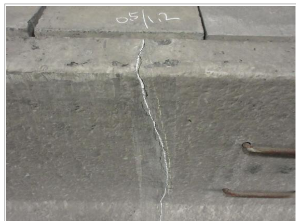
Span77 공동구 벽체 균열(0.5mm/1.2m)
