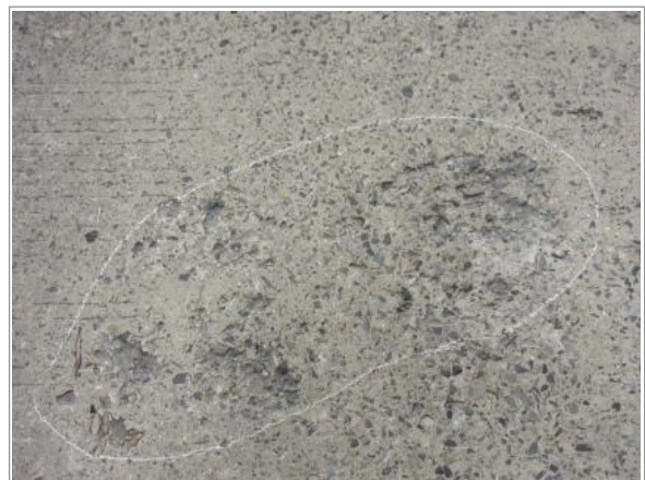
Span21 포장면 재료분리
