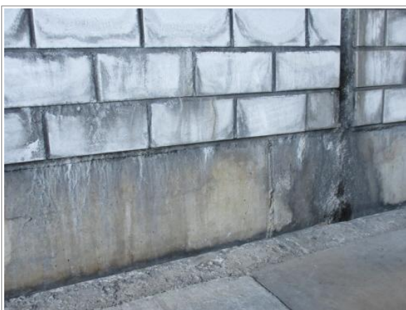
Span181 벽체부 백태(0.5×1.2)
