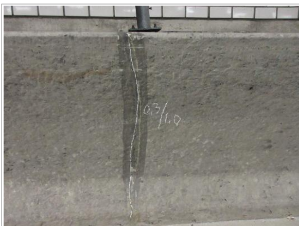
Span29 공동구 벽체 균열(0.3mm/1.0m)
