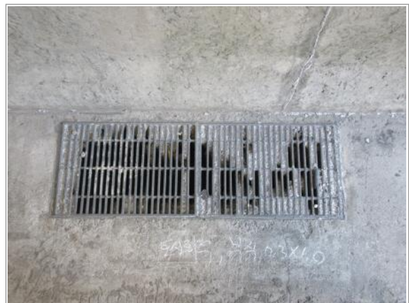
Span169 집수구 토사퇴적 및 스틸그레이팅 부식
