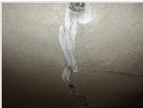
Span154 천단부 종균열(cw=0.3mm/9.0m, 보수미흡)
