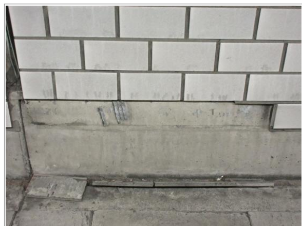
Span142 측벽부 타일 탈락
