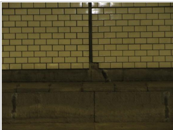
Span119 측벽부 타일 탈락
