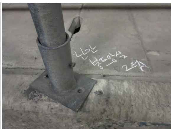
Span99 공동구 난간 볼트망실
