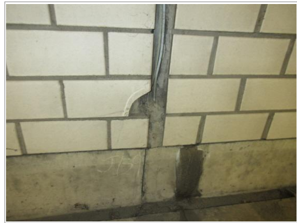
Span158 측벽부 타일 파손
