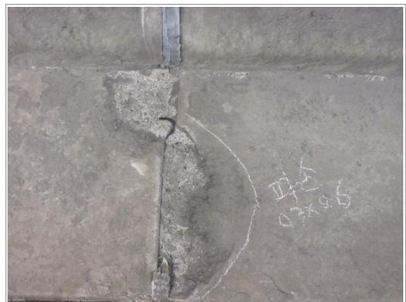
Span137 측구 파손 (0.3×0.6)
