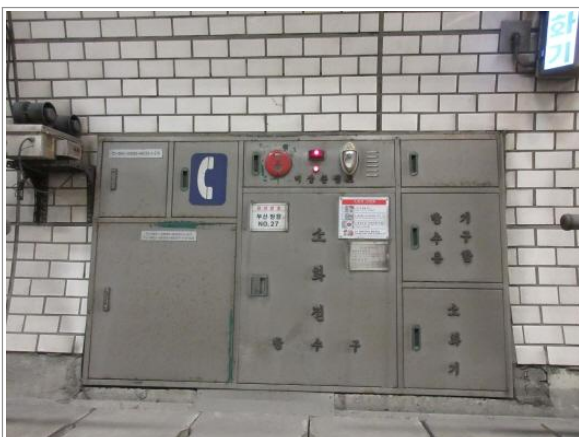
소화기 및 비상전화, 비상콘센트 전경
