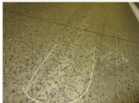
Span144 포장면 재료분리
