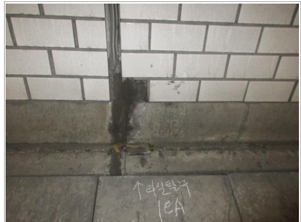
Span102 측벽부 타일 탈락
